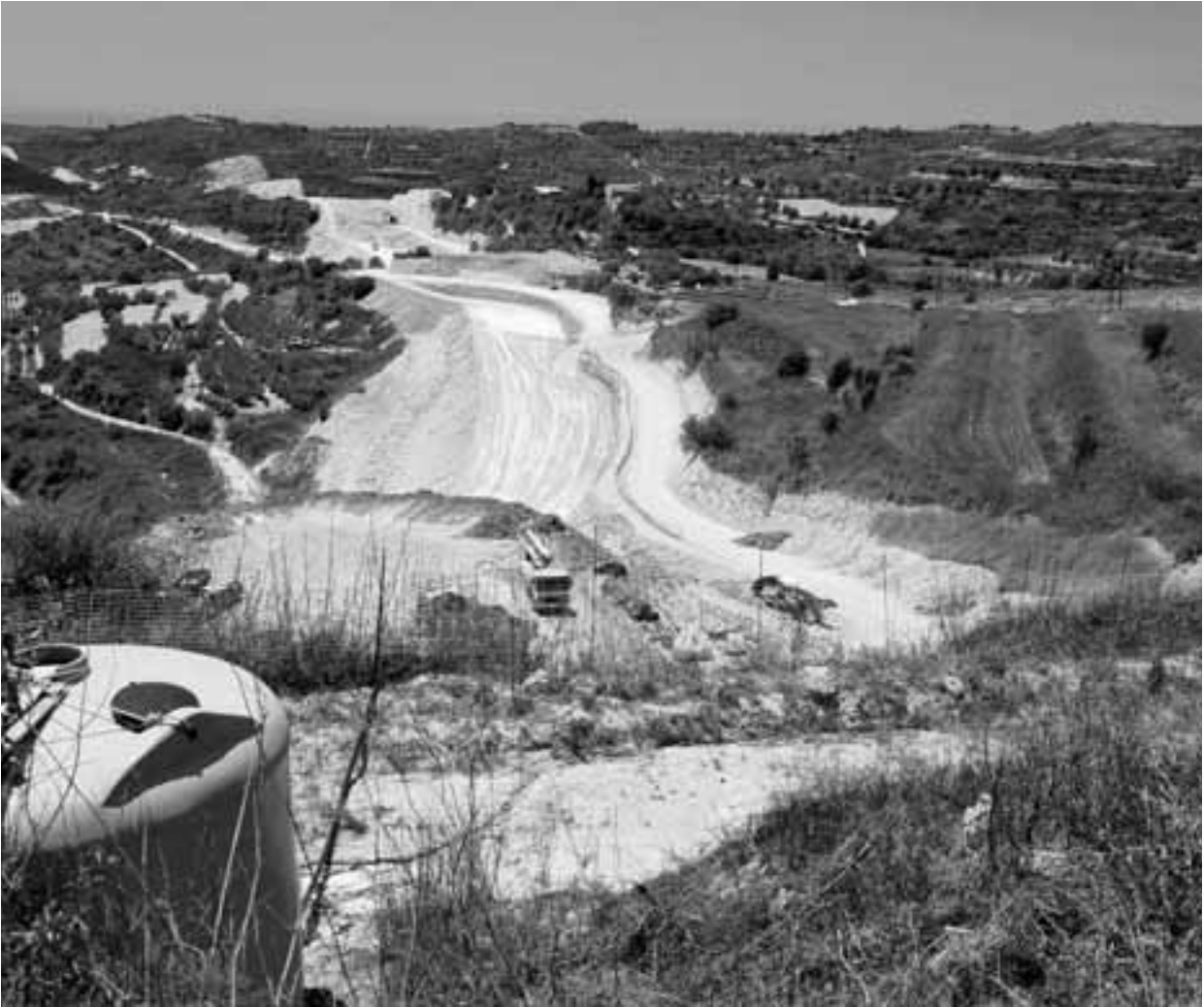
Ο αντιδήμαρχος Δρούσιας Σωτήρης Κουμπάρης ζητά τη διεξαγωγή έρευνας για την κατάσταση στην οποία έχει περιέλθει το οδικό έργο, με την απόδοση ευθυνών σε πολιτικό και υπηρειακό επίπεδο.
