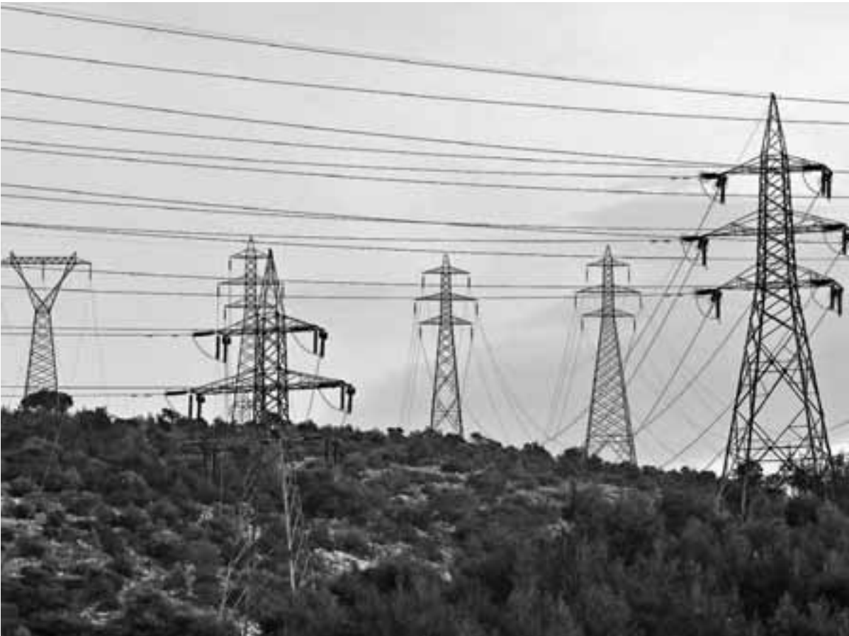
Το δίκτυο αναπτύχθηκε επί δεκαετίες, με διαφορετικά υλικά, κατασκευαστές και τεχνικές προδιαγραφές. Άνθρωποι που γνωρίζουν τις τεχνικές βάσεις δεδομένων του διαχειριστή υποστηρίζουν ότι εξακολουθούν να υπάρχουν κενά στην ακριβή γεωγραφική και τεχνική ταυτοποίηση στοιχείων του, από στύλους και καλώδια έως μετασχηματιστές και υποσταθμούς.
