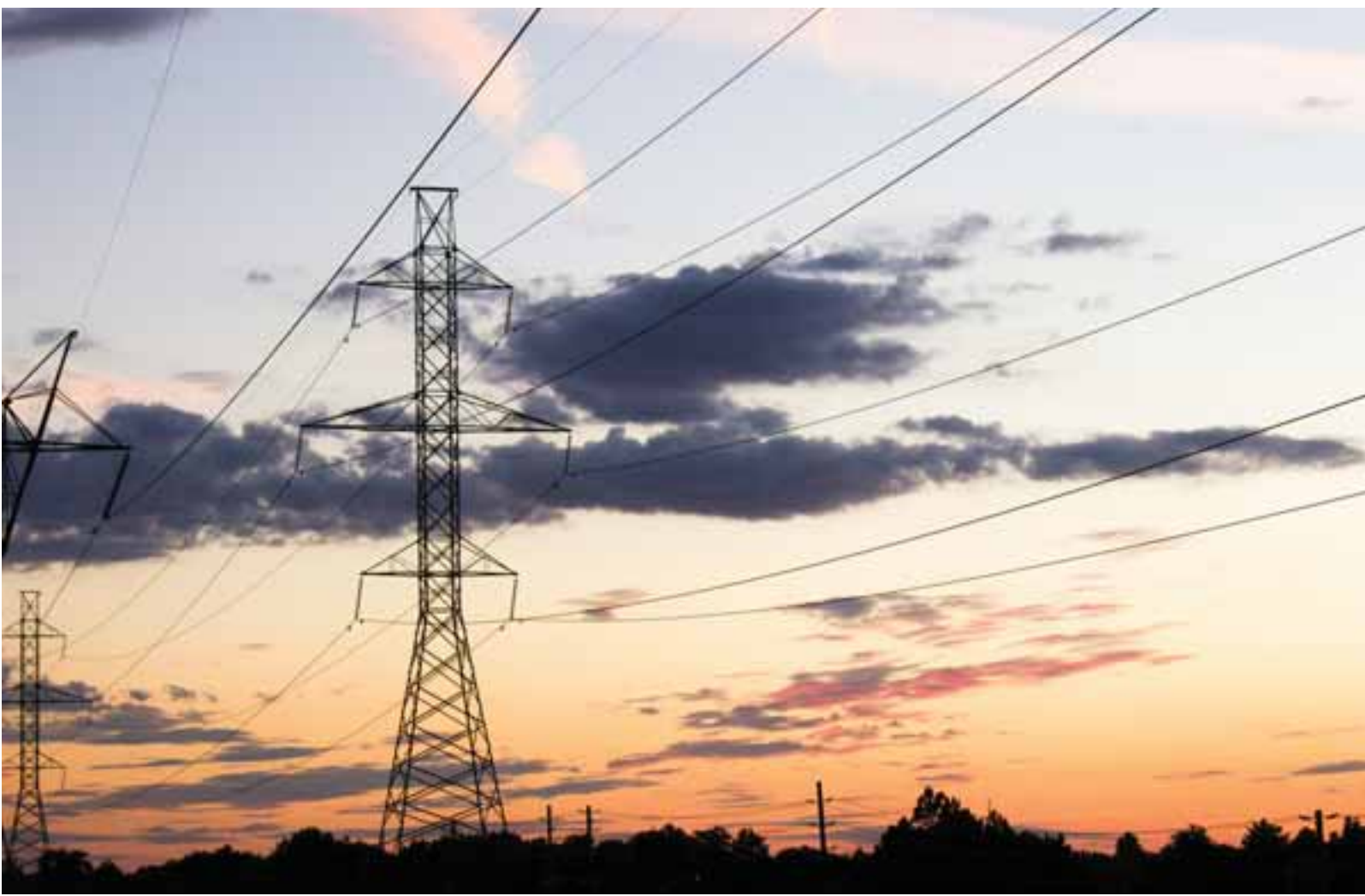
Με βάση επίσημα στοιχεία, τις τελευταίες ημέρες η κάλυψη ηλεκτρικής ενέργειας κινείται σε οριακά επίπεδα, με τον Διαχειριστή Συστήματος Μεταφοράς Κύπρου να διαφύδει δημοσιεύματα για διακοπές ρεύματος σε ορεινές κοινότητες που αποδίδονταν στο σύστημα παραγωγής.
