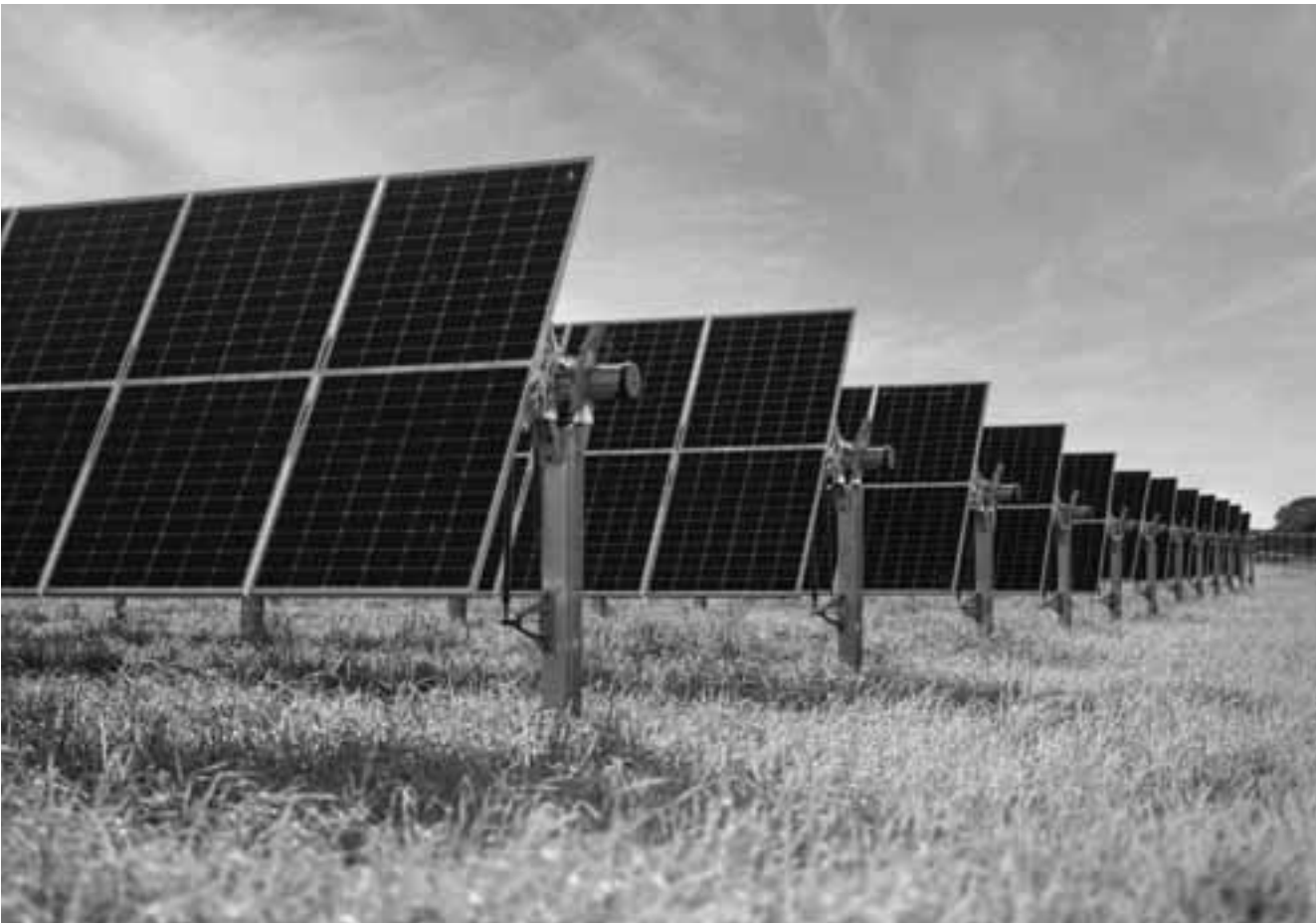
Πρόκειται για φωτοβολταϊκό πάρκο ισχύος 180MW και μονάδων αποθήκευσης ενέργειας ισχύος 40MW, εντός των διοικητικών ορίων των κοινοτήτων Καταλιόντα, Λυθροδόντα και Μαθιάτν.
