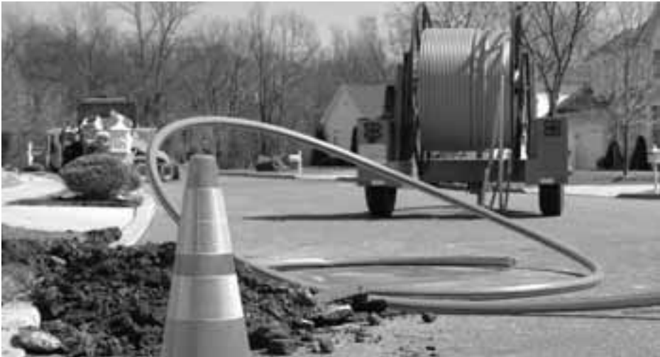
Μέχρι το καλοκαίρι η Vodafone αναμένεται να έχει ολοκληρώσει την ανάπτυξη 670 χλμ. υποβρύχιου και 800 χλμ. υπόγειου καλωδίου που θα διέρχεται από τις Κυκλάδες και θα διασυνδέεται με τα Δωδεκάνησα και την Κρήτη.
