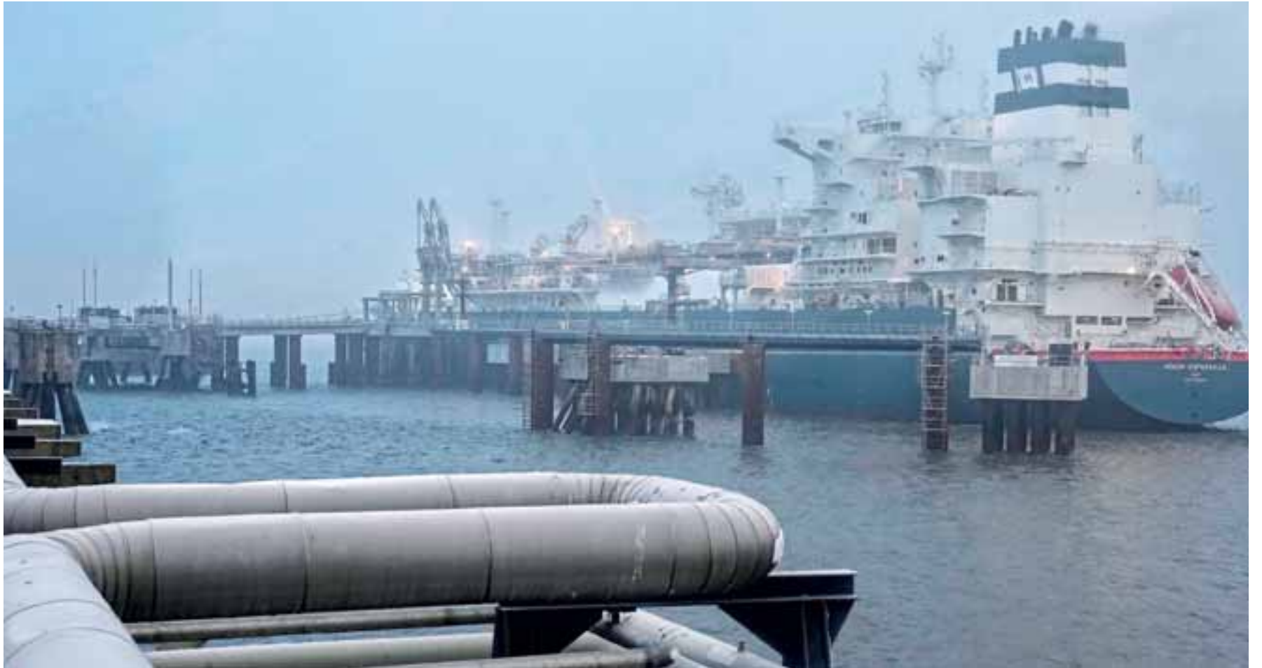
Στις εισαγωγές υγροποιημένου φυσικού αερίου (LNG) στρέφεται η Ευρώπη και ήδη ορισμένες χώρες, όπως η Γερμανία, η Πολωνία και η Ολλανδία, κατασκευάζουν τερματικούς σταθμούς. Στη φωτογραφία, ο σταθμός στο Βίλχελμσβαεν, που εγκαινίασε την περασμένη εβδομάδα ο Γερμανός καγκελάριος Όλαφ Σόλτς.
