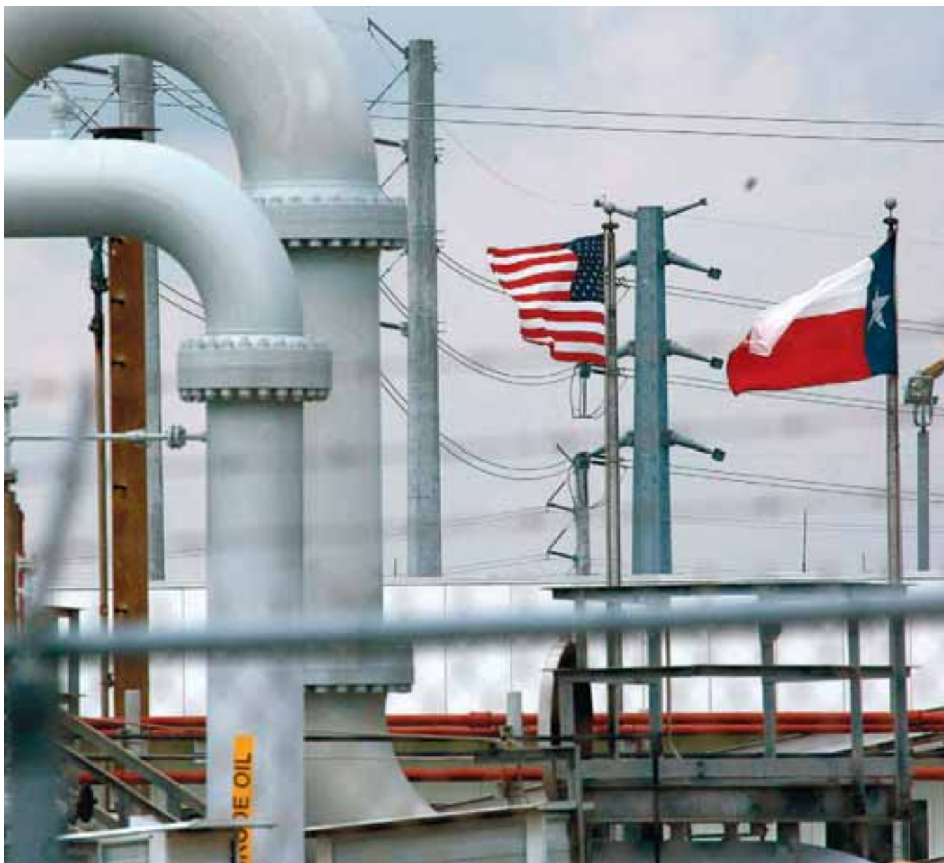
Το εργοστάσιο Freeport στο Τέξας, το οποίο έχει την ικανότητα να αποστέλλει περίπου 15 εκατομμύρια τόνους ετησίως, προμηθεύει αέριο τους ενεργειακούς κολοσσούς της BP και της TotalEnergies στην Ευρώπη, καθώς και τις ιαπωνικές Jera και Osaka Gas και την SK E&S στη Νότια Κορέα.
