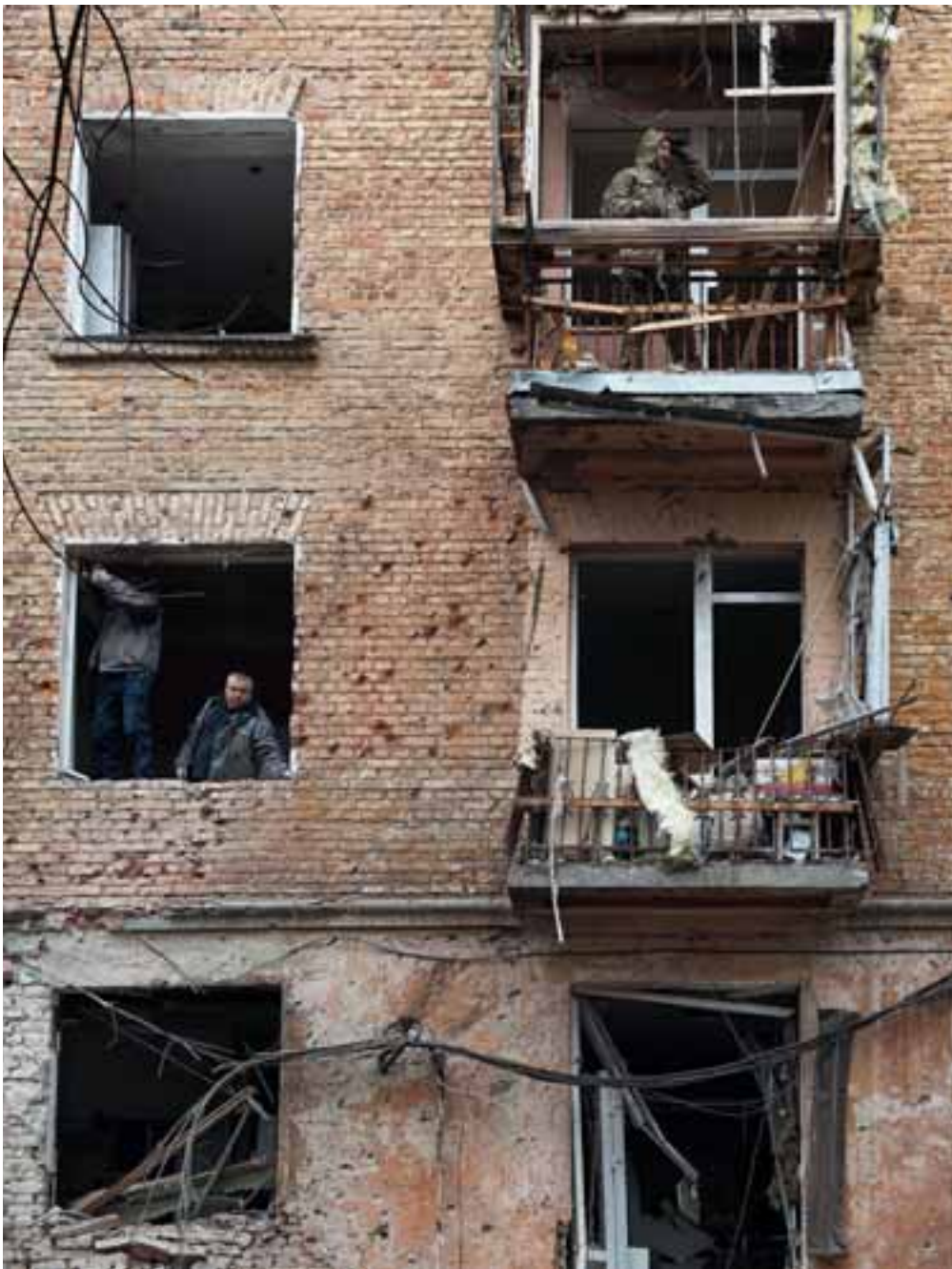
Καταστροφές σε πολυκατοικία έπειτα από επίθεση ρωσικού drone στο Τσερνίβιχ κατά τη διάρκεια της νύχτας. «Το δάνειο επανορθώσεων δεν είναι μόνο η ελάχιστη απονομή δικαιοσύνης, είναι ζήτημα επιβίωσης», λέει ο Αντριου Κοσένκο και υπογραμμίζει ότι «η υπεράσπιση της Ουκρανίας είναι υπεράσπιση της Ευρώπης».
