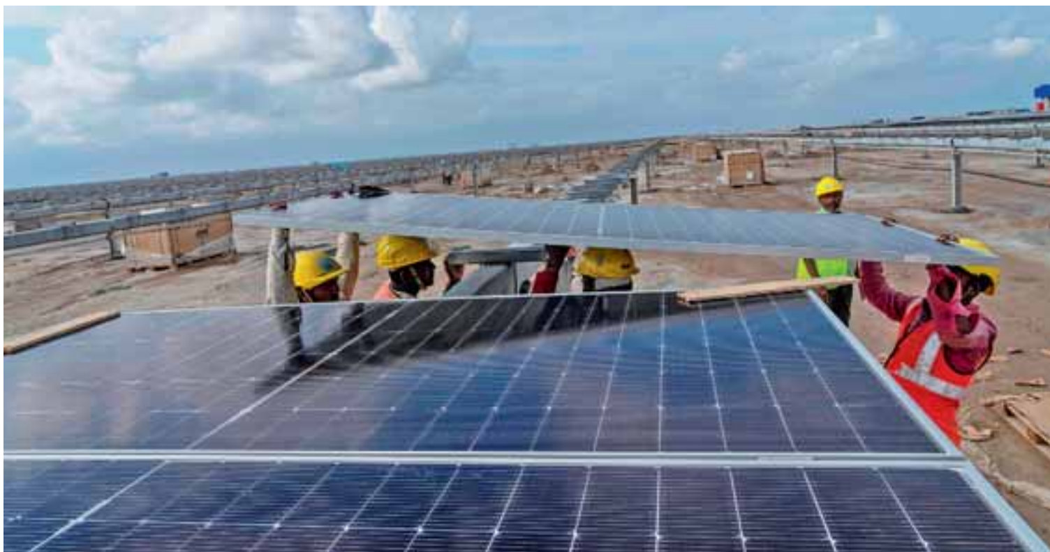
Το πάρκο ανανεώσιμων πηγών Kvanva είναι υπό κατασκευή στην άγονη έρημο της δυτικής Ινδίας, κοντά στα σύνορα με το Πακιστάν. Αναμένεται να ολοκληρωθεί σε πέντε χρόνια και θα είναι η μεγαλύτερη μονάδα ηλιακής και αιολικής ενέργειας του κόσμου.
