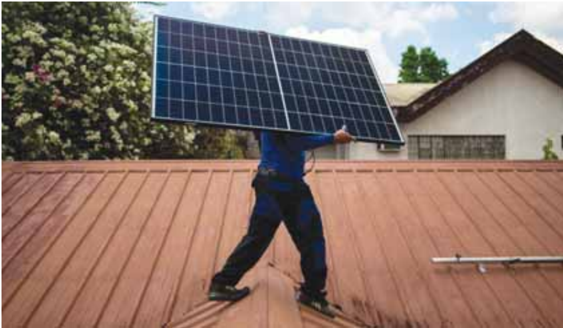
Το όριο στην ισχύ του εγκατεστημένου φωτοβολταϊκού είναι 4,16 κιλοβάτ, ώστε να απευθύνεται σε μικρά και μεσαία σπίτια.
