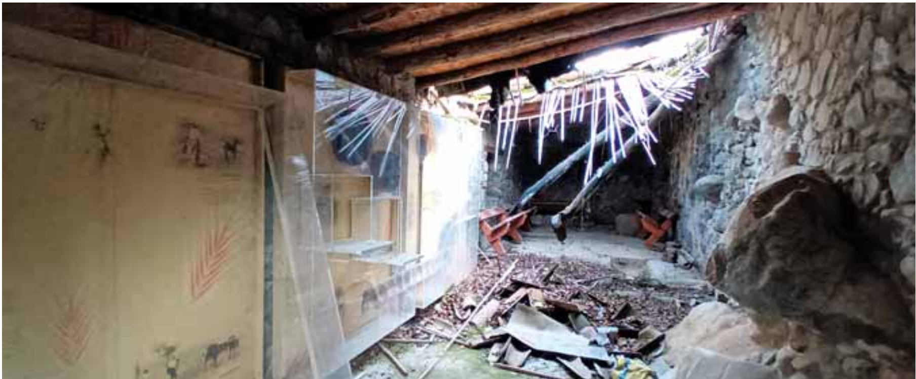
Ο αποκατεστημένος Μύλος της Ρόδου στη Γαλάτα (2000-2002) σήμερα δεν είναι τίποτε άλλο παρά ένα ερείπιο. Τα εκθέματα που υπήρχαν (παλιά εργαλεία του νερόμυλου) έγιναν ένα με τις πέτρες και τα ξύλα, οι εννημερωτικές πινακίδες σάπιες και γενικά ο χώρος όχι μόνο δεν είναι επισκέψιμος, αλλά είναι και επικίνδυνος. Αγαπάμε το πολιτιστικό μας απόθεμα!
