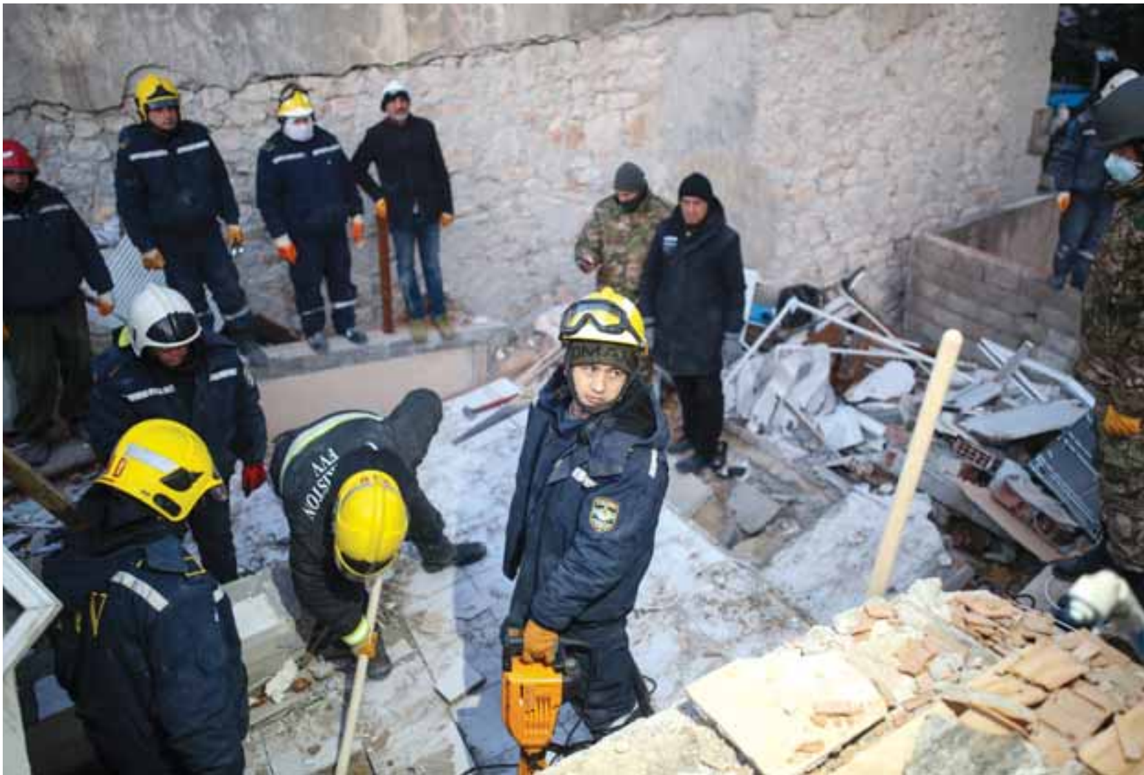
Ομάδα διάσωσης από το Ουζμπεκιστάν εργάζεται σε κτίριο που κατέρρευσε μετά από τον ισχυρό σεισμό στο Hatay της νοτιοανατολικής Τουρκίας.
