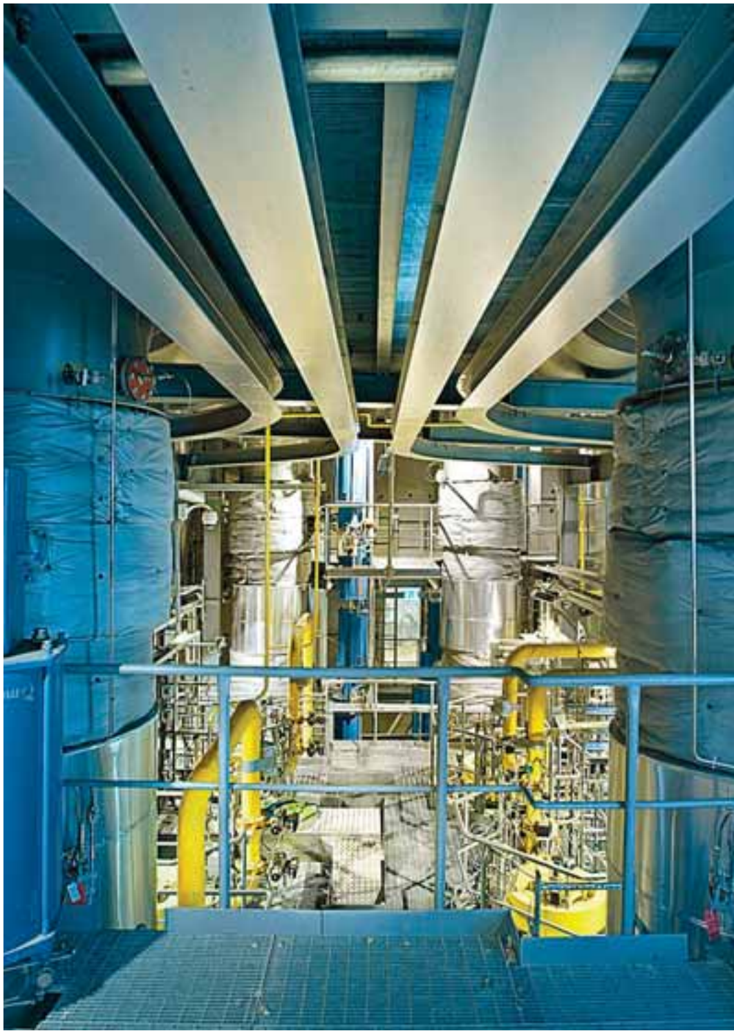
Η μονάδα παραγωγής ενέργειας Κίμιγιαρβι βασίζεται στην «αεριοποίηση» απορριμμάτων και βιοκαυσίμων.
