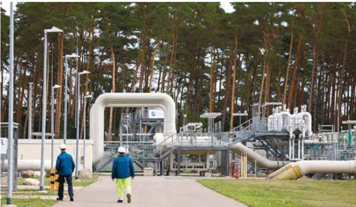
Τμήμα του Nord Stream 1 στο Λούμπιν της Γερμανίας. Η Ρωσία περιορίσε στο 20% τις ροές φυσικού αερίου στον αγωγό, εντείνοντας την πίεση στο Βερολίνο. Η απειλή ενός εφιαλτικού χειμώνα στην Ε.Ε., όπου εκατομμύρια άνθρωποι θα κληθούν να διαλέξουν αν θα πεινάσουν ή θα ξεπασιάσουν, βρίσκεται επί θύραις.
