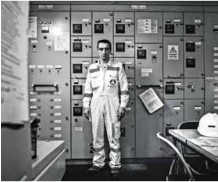
Ο Α΄ μηχανικός στον πίνακα ελέγχου του μηχανοστασίου.
