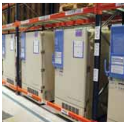
Τα εμβόλια της Pfizer-BioNTech θα μεταφερθούν κάτω από αυστηρά μέτρα προστασίας σε χώρο, στον οποίο έχει εγκατασταθεί η υποδομή των ειδικών ψυγείων.
