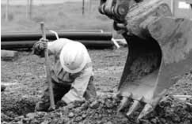
Αυτή η περίοδος είναι κατάλληλη για να προβείτε σε ελέγχους των διαφόρων συστημάτων που έχει το κτήριο σας και για επιδιορθώσεις ζημιών.
