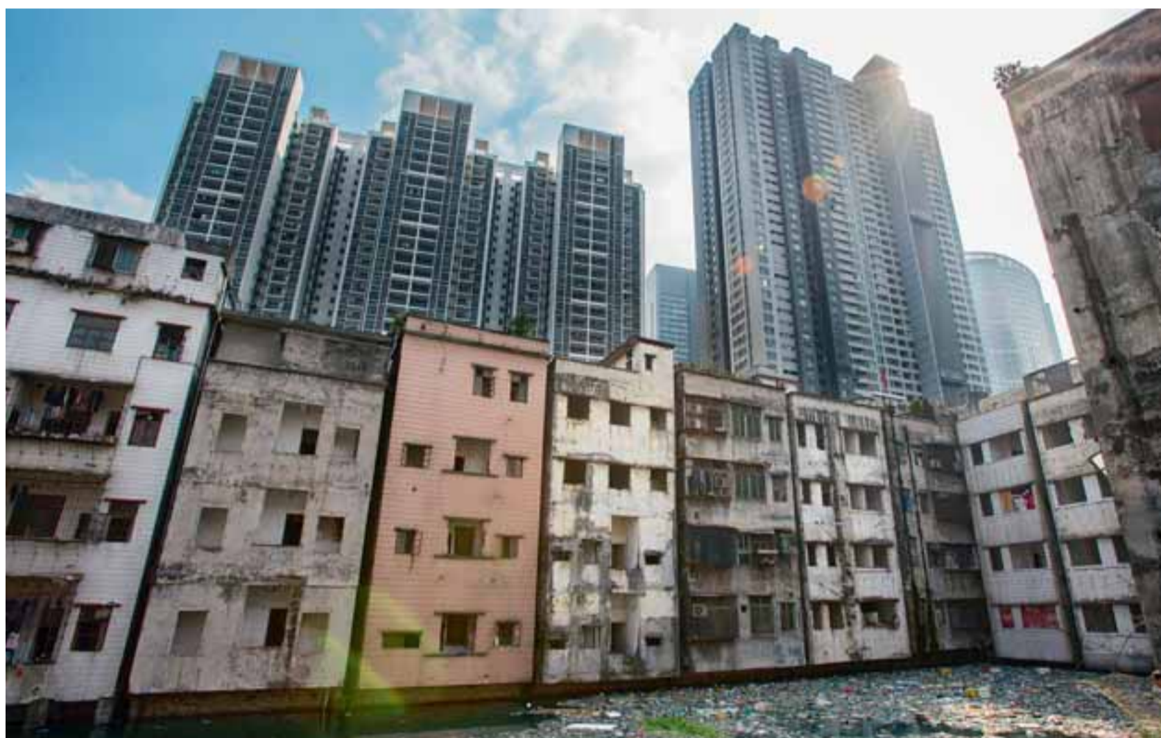
Ετοιμόρροπα διαμερίσματα στο Κουανγκτσόου, στη σκιά των νέων, σύγχρονων κτιρίων γραφείων και κατοικιών.
