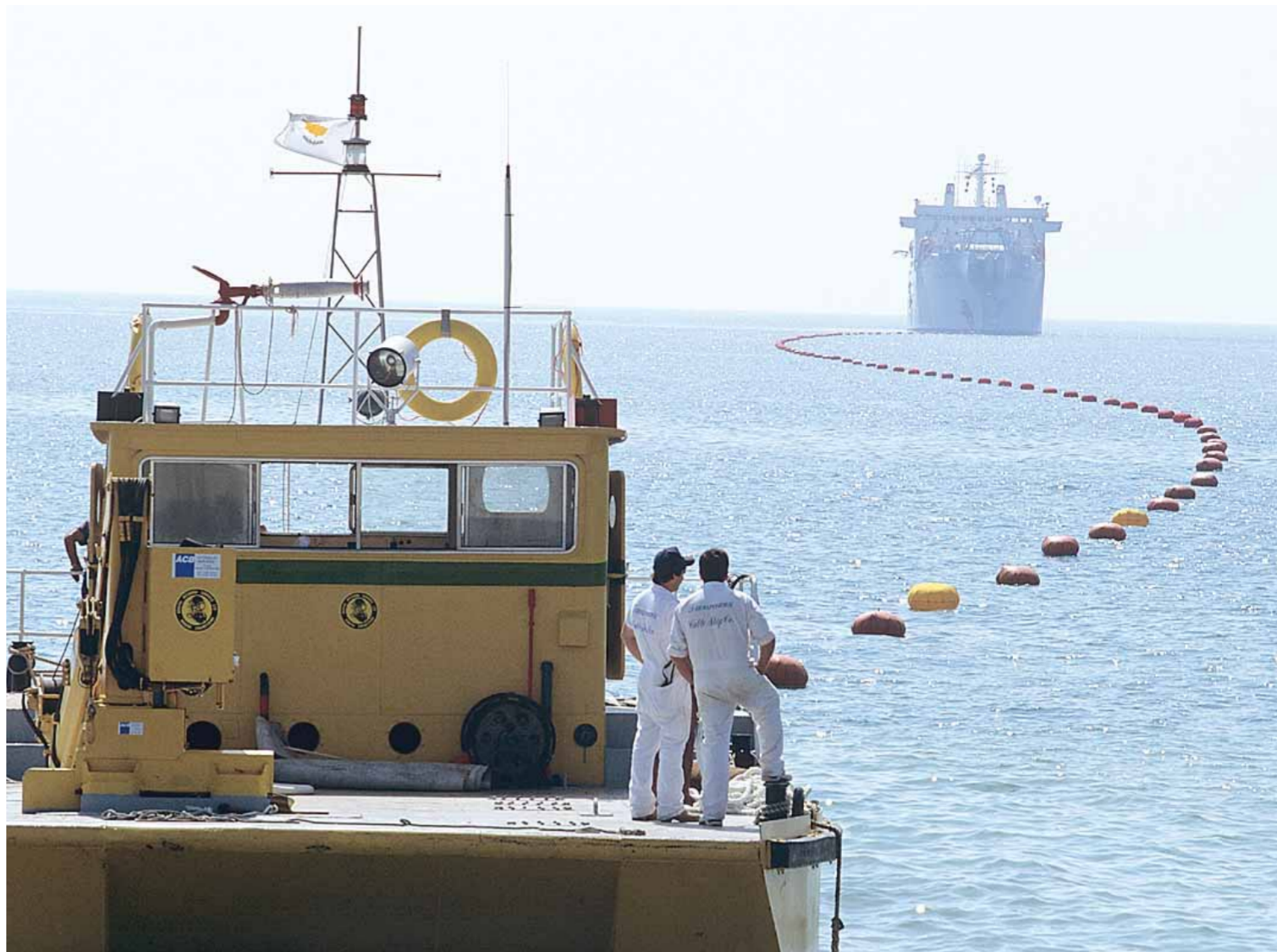
Το ηλεκτρικό καλώδιο θα είναι μήκους 1.518 χλμ. δυναμικότητας 2.000 MW και η εκτέλεση του έργου θα πραγματοποιηθεί σε τρεις φάσεις. Το έργο με βάση το χρονικό πλαίσιο θα παραδοθεί το 2022 με τη σύνδεση Κύπρου-Κρήτης.
