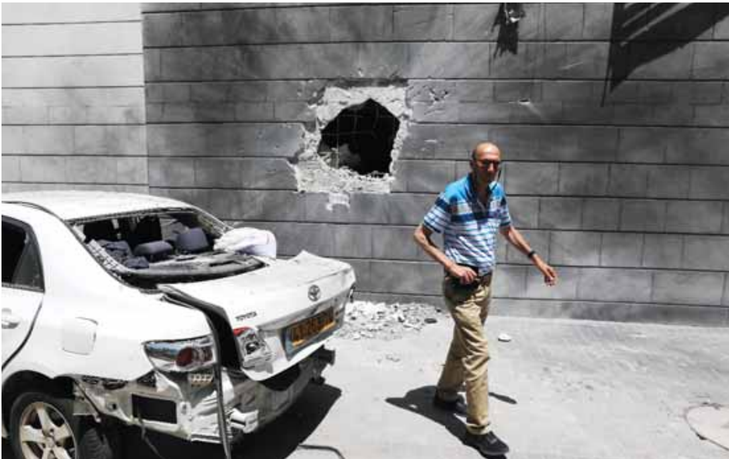
Στην πόλη Ashkelon του Ισραήλ οι καταστροφές από τις βίαιες συγκρούσεις Αράβων και Ισραηλινών είναι πολλές και σοβαρές. Παρόμοια κατάσταση παρουσιάζουν και πολλές άλλες πόλεις του Ισραήλ, με την κατάσταση να οδηγείται στα άκρα.
