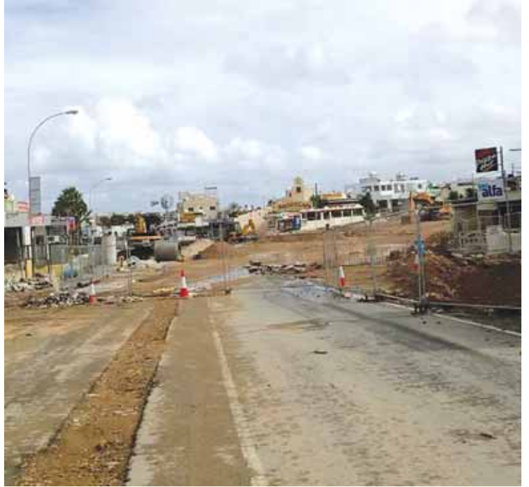
Μάρτιος 2017. Ένα χρόνο πριν οι υπό κατασκευή δρόμοι στη Λεωφόρο Πρωταρά έμοιαζαν με λίμνη, μετά τις βροχές στην περιοχή.
