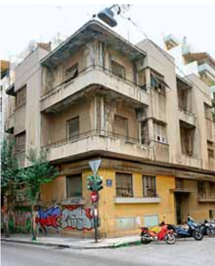
Δροσοπούλου και Θήρας, κοντά στη Φωκίωνος Νέγρη. Εγκαταλειμμένο κτίριο του Μεσοπολέμου.
