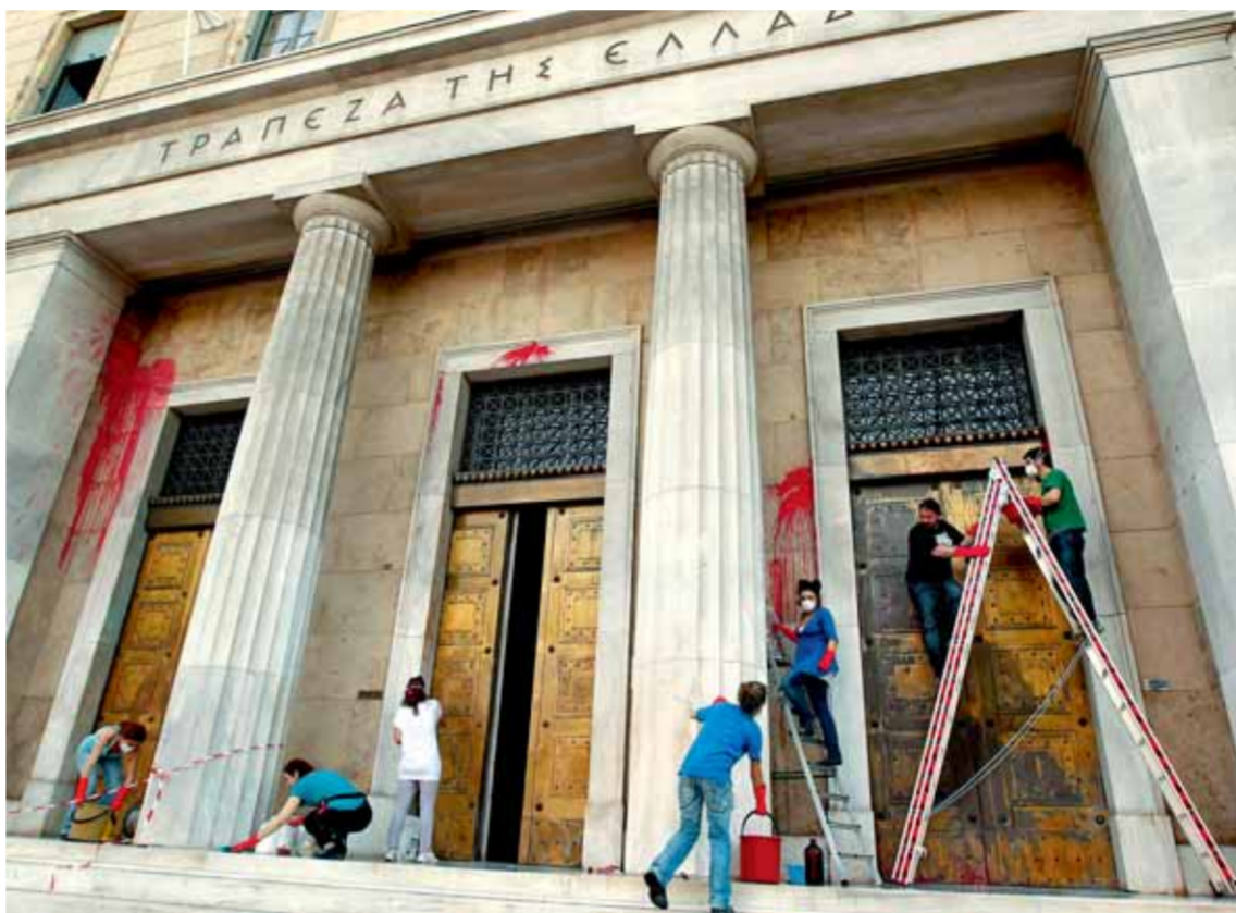
Αποκατάσταση ζημιών στην είσοδο της Τράπεζας της Ελλάδος, μετά τους βανδαλισμούς από «γνωστούς άγνωστους». Εύγλωττα απεικόνιση της ανατρεπτικής μανίας κάποιων, αλλά και της θέλησης των εκχερρμένων να εμποδίσουν τη χώρα να φτάσει στο τελευταίο σκαλοπάτι της καταστροφής.
