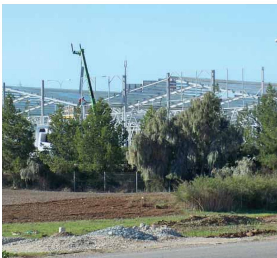
Το νέο mall θα κτιστεί δίπλα στο υπό ανέγερση κατάστημα Ellinas DIY.
